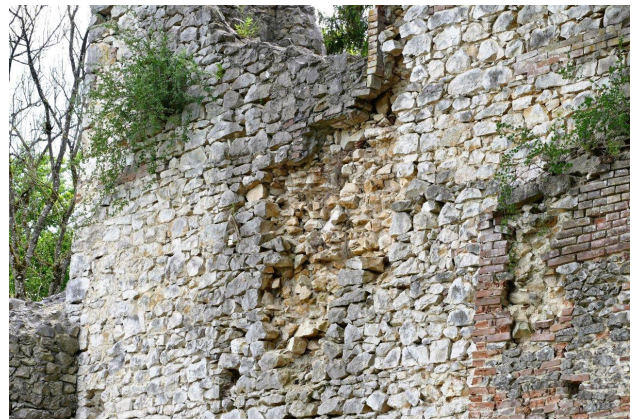
Schadensbild westliche Schildmauer im August 2017
