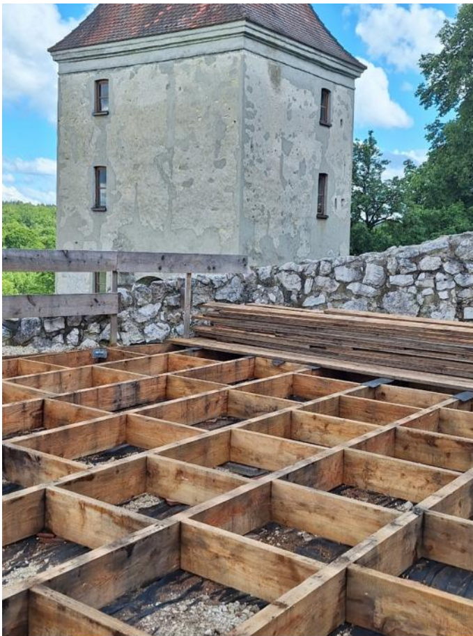
Neuausrichtung Belag Bühne Torhaus wg. Fehlerhafter 1. Belegung der Dielen
