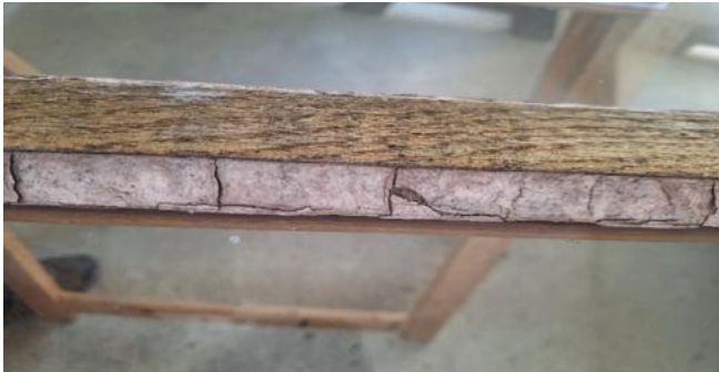
Schäden an den Fenstern mussten ausgebessert werden
